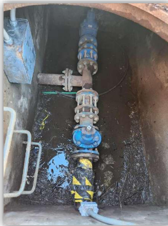
Figura 2-6: Conexión cámara de válvulas a telemetría producción SSR Valle Simpson
