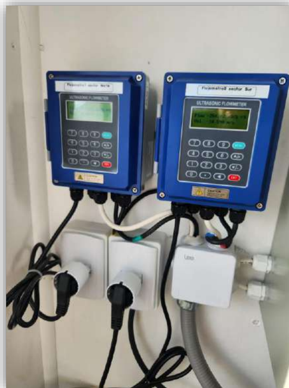
Figura 2-7: Panel telemetría producción SSR Valle Simpson
