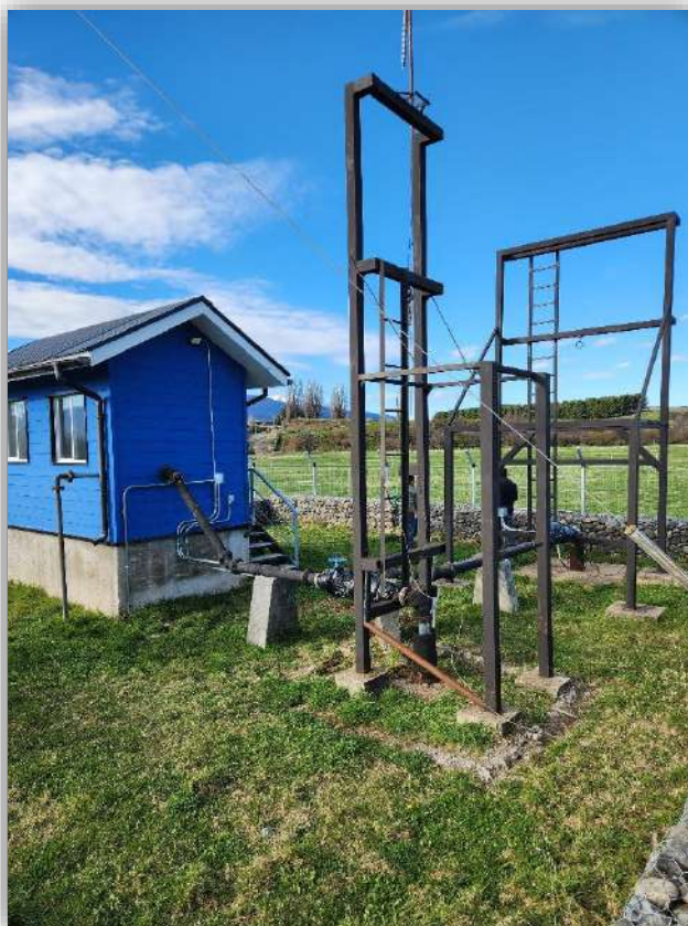
Figura 2-3: Captación subterránea Valle Simpson
