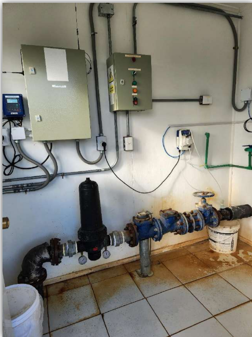
Figura 2-4: Filtro en línea e Inyección de Cloro
